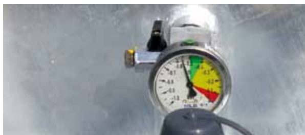
Vakuuminė nuotėkio stebėsenos sistema
