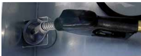
Резервуар для утечек
