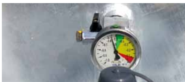
Supervisión de fugas por vacío
